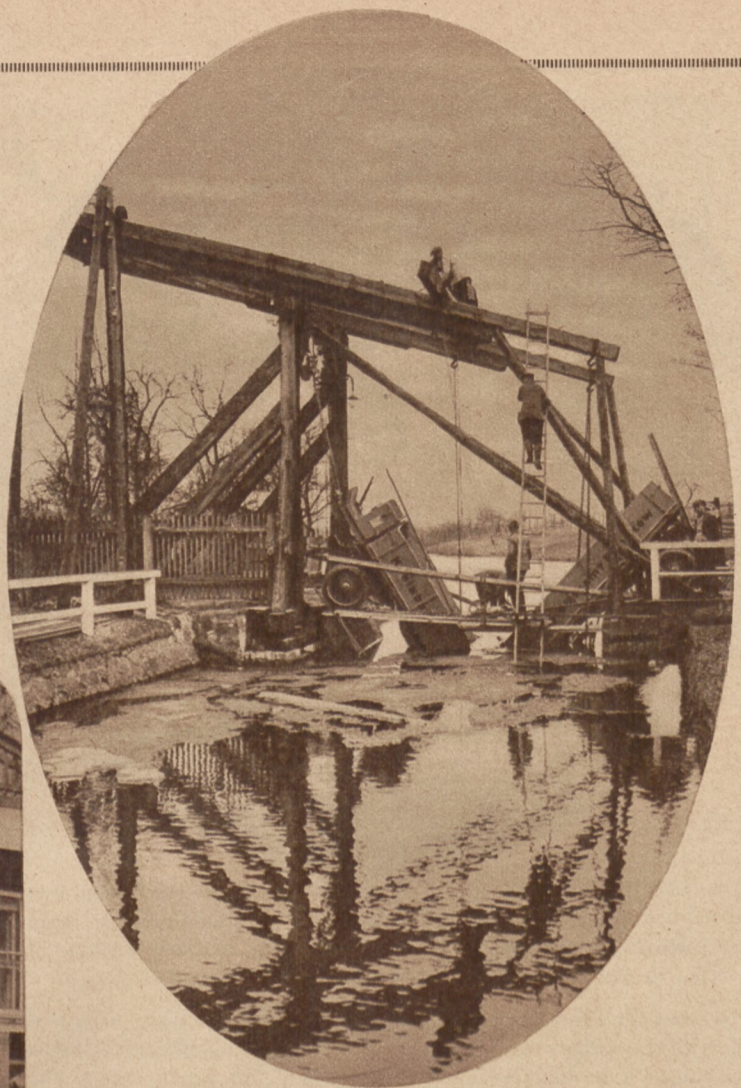
Die alte hölzerne Zugbrücke über den Storkow-Kanal in der Nähe des Scharmüßelsees (Mark Brandenburg) brach zu- sammen, als ein schwerer Lastzug sie überfuhr. Für solche schweren Motorfahrzeuge reichte ihr leichter hoher Bau nicht aus. — Der auf einem der Wagen befindliche Mitfahrer kam bei dem Zu- sammenbruch ums Leben Photo-Union
