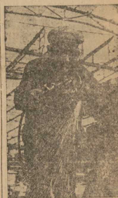
Firma „Mostostal” buduje na Okęcu w Warszawie nową hangary dla PLL „Lotu”.
