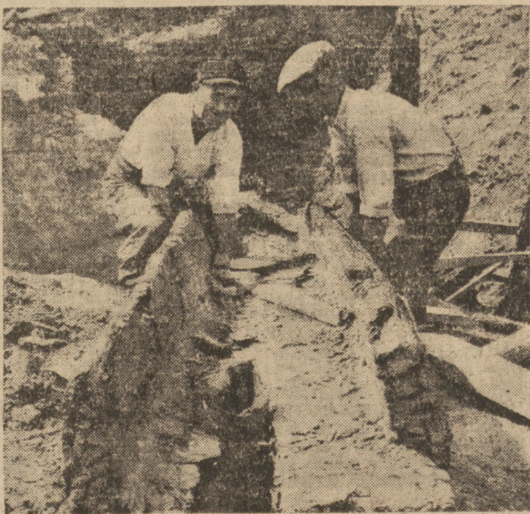
Robotnicy, pracujący przy budowie trasy WZ na placu Zamkowym natrafili na drewniane rury kanalizacyjne i wodociągowe
