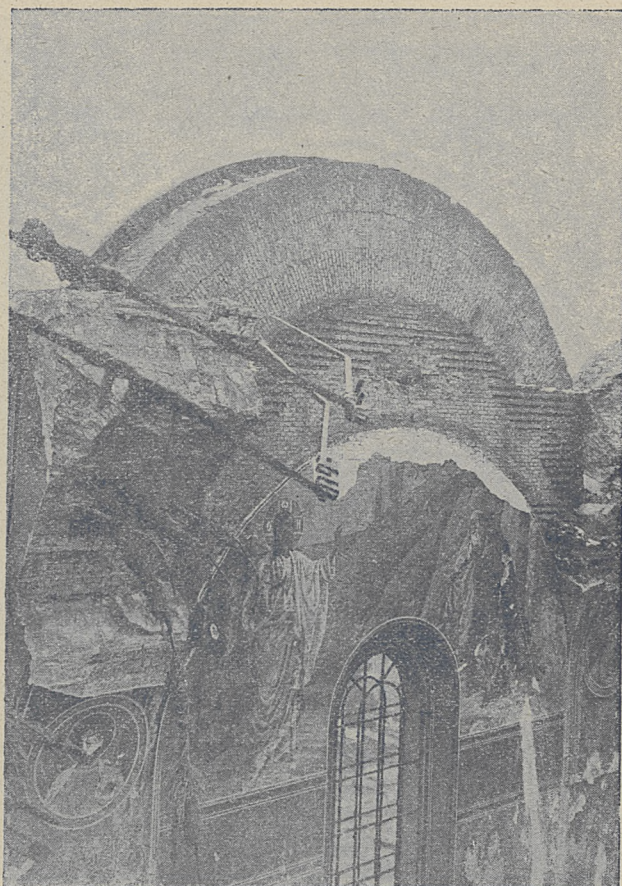
Górne części soboru po opadnięciu sklepienia, widoczne z wysokości piątego piętra.
