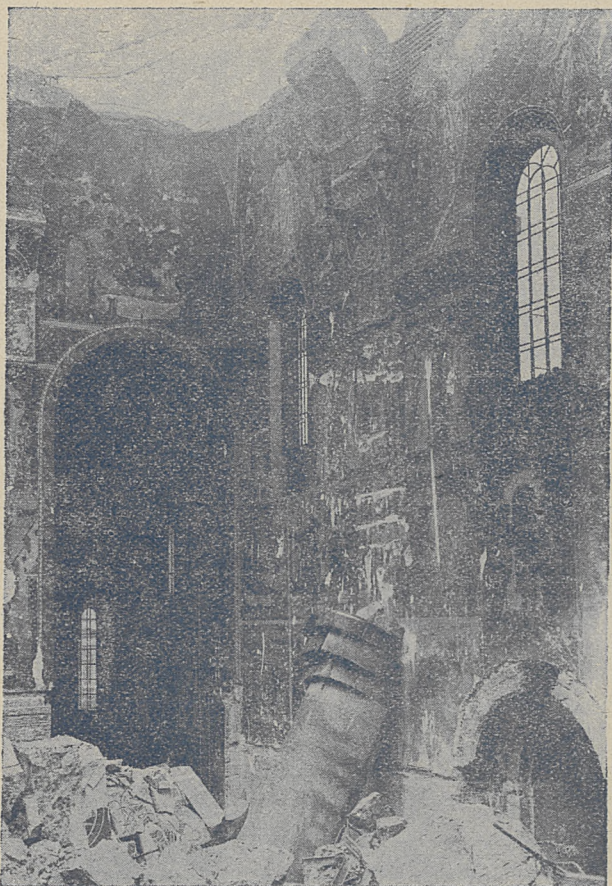
Rozwalone kolumny, podtrzymujące wraz z ankrami żelaznymi sklepienie.
