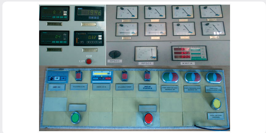
Fot. 1. Fragment dawnej nastawni z aparaturą kontrolno-pomiarową
