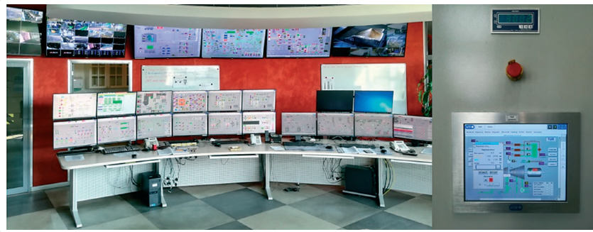
Fot. 3. Fragment nowoczesnej nastawni systemu DCS MASTER z monitorami LCD oraz widok panelu dotykowego
