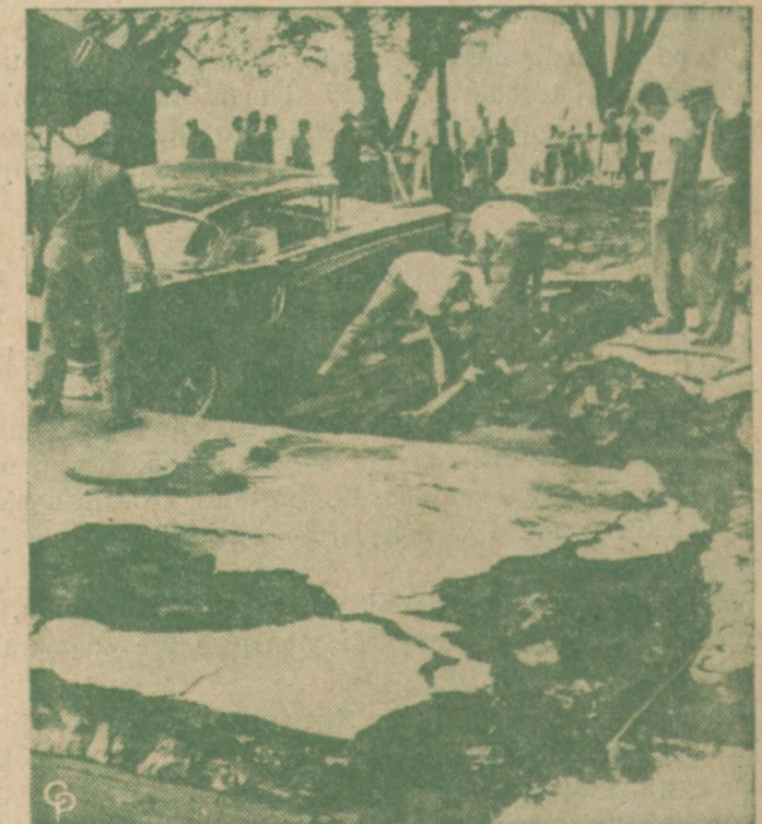
ZAPADŁA SIĘ JEZDNI. — Pewna część jezdni na ulicy East River Drive w Filadelfii, Pa., zapadła się z powodu przerwania się głównej rury przeprowadzającej wodę pod ziemią. Musiano użyć robotników, aby ratować młodą parę, która autem zatrzymała się przypadkiem w miejscu, gdzie jezdni się zapadła.
