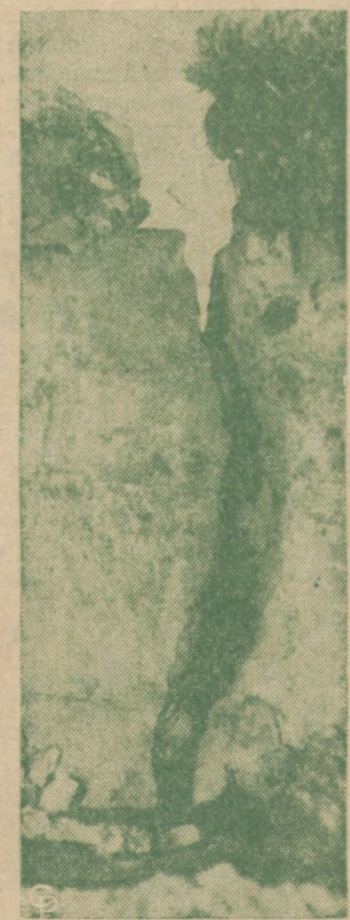
POWÓD DO OBAWY. Szczelina na tamie wodnej Hebgen w Montanie, utworzona w czasie trzęsienia ziemi w Yellowstone Parku, stanowi powód do obaw, że ta pęknie, tymbardziej, że lekkie wstrząsy dają się odczuwać jeszcze i dziś w tym rejonie. Służba alarmowa trwa tam przez 24 godzin każdego dnia.
