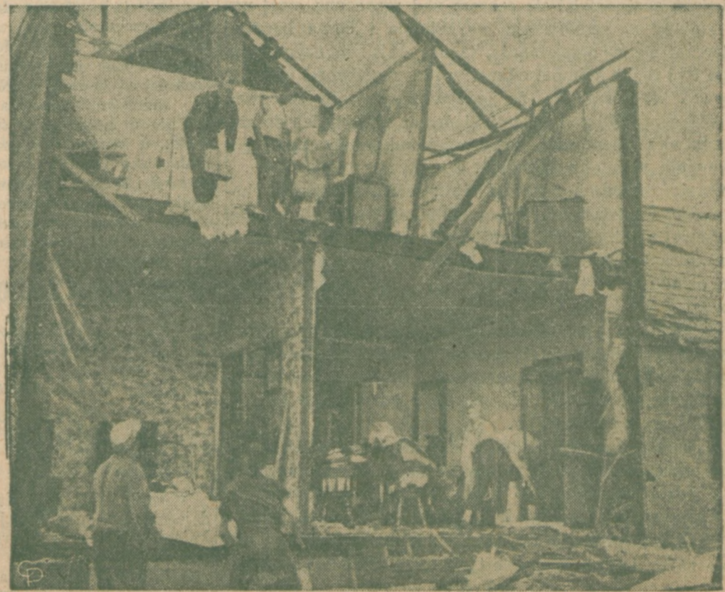
NA SZLAKU TRĄBY POWIETRZNEJ W EXLINE, ILL. — Trąba powietrzna przeszła swym niszczycielskim szlakiem poprzez miejscowość Exline w stanie Illinois. Rozdarła jeden z domów mieszkalnych na dwie połowy. Widok tego domu i mieszkańców — na zdjęciu. Silne tornada przeszły również poprzez stany Michigan i Missouri.
