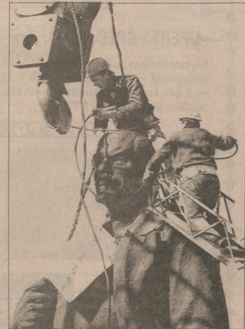
Robotnicy mocują liny na 7-tonowym pomniku Lenina w Bukareszcie podczas prawie trzydniowych zmagani z nieustępliwą konstrukcją.
