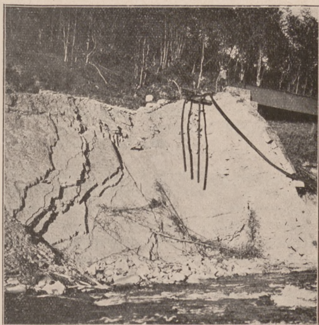
Powódź w dorzeczu Prutu w dn. 30 i 31 sierpnia 1927 r. Zniszczony tor kolejowy na linii Stanisławów-Woronienka. L'inondation dans le bassin du Pruth les 30 et 31 août 1927. Le chemin de fer Stanisławów-Woronienka miné par l'inondation.
