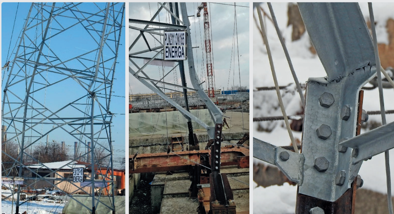
Fot. 2. Zniszczenie słupa PLN122 P (po lewej), słupa PLN122 ON165 (środek) oraz słupa PLN211 P (po prawej)
