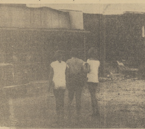
Uczennice przypatrują się robotnikom, którzy zaczęli czyszczyć i naprawiać szkołę Hattie Cotton w Nashville, Tenn. częściowo zburzoną podczas rozruchów w związku z integracją. Szkoła będzie otwarta za parę dni.
