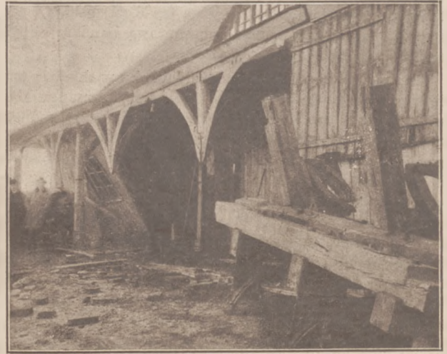
Narożnik przystani Kl. Wiośl. „Wisła” zdemolowany uderzeniem kry podczas wylewu w roku 1924.
