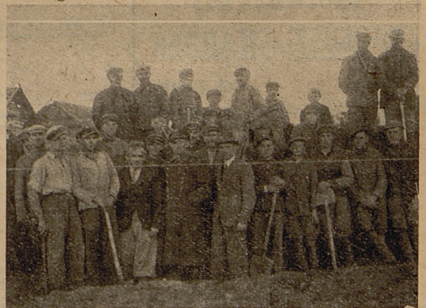
Grupa strzelców O. Z. S. Żuprany, która wzięła bezinteresowny udział w kopaniu fundamentów pod miejscową szkołę powszechną.
