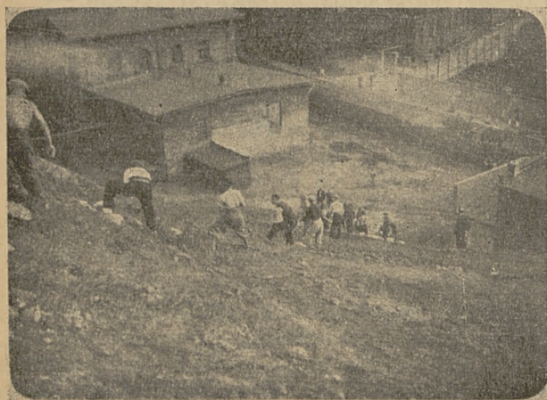
Łańcuch strzelców transportujących cegłę i materiały na teren przeznaczony pod budowę strzelnicy Oddziału Huta Katarzyna.
