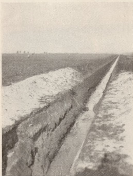
Rys. 3. Rów o niewłaściwej skarpie
