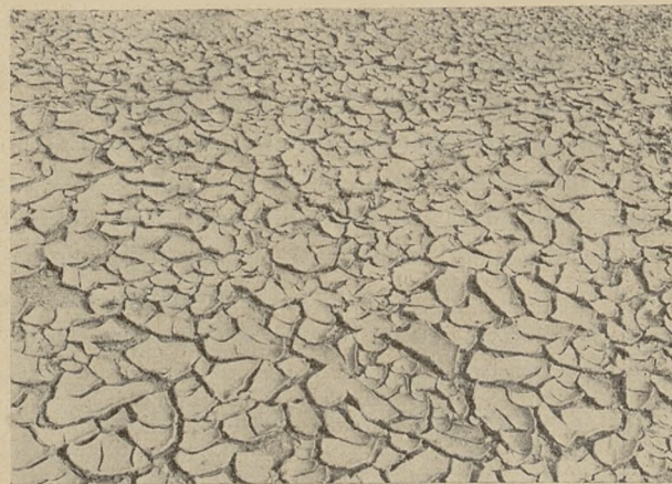
Rys. 2. Zeschnięta skorupa na filtrze wodociągowym.
