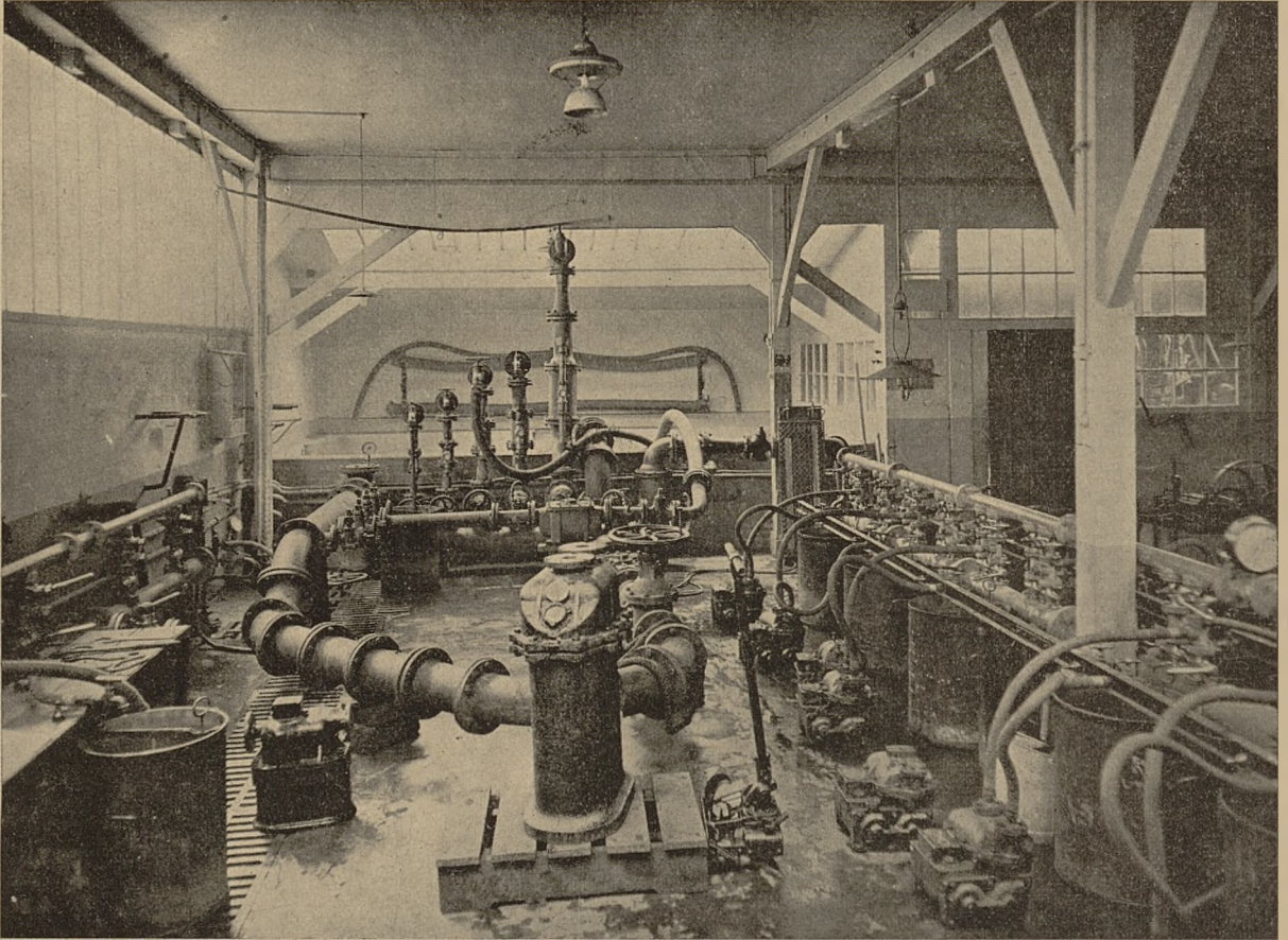
Rys. 2. Pracownia dla sprawdzania wodomierzy Zakładu wodociągowego m. Paryża.
