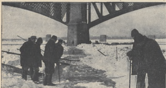
W celu zabezpieczenia filarów mostu Ks. Poniatowskiego w Warszawie, przerabano obok nich niezwykle w tym roku grubą kę. (Photo Plat.).
