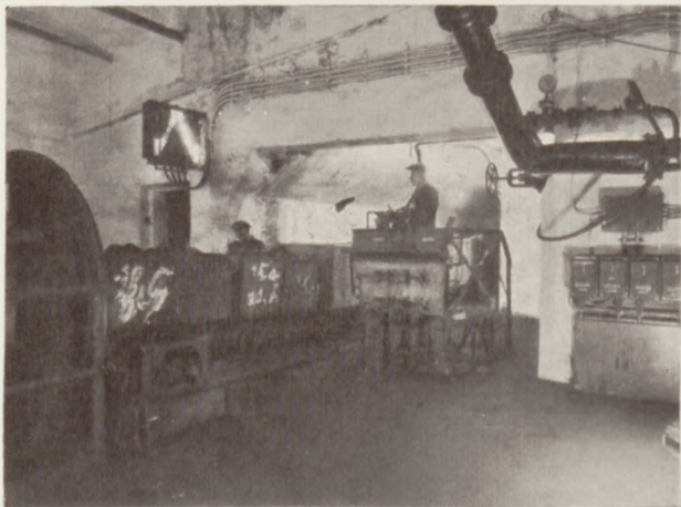
Stanowisko sterownicze. Na lewo widać wywrót, nieco wyżej, sygnalizację świetlną.
