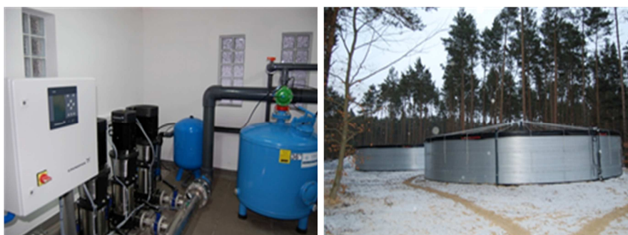
Systemy magazynowania i dystrybucji wody
