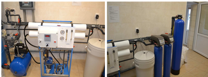
Systemy filtracji i uzdatniania wody
