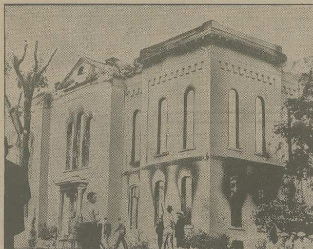
Das Gerichtsgebäude von Sherman nach dem Brand.
