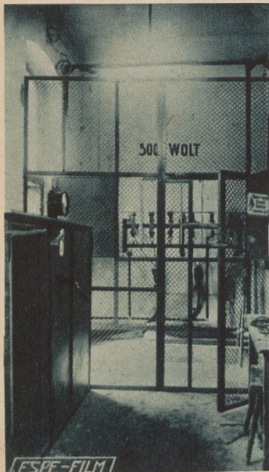
Transformatornia wysokiego napięcia
