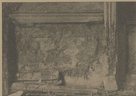
Rys. 3. Ściana pokryta grzybem.
