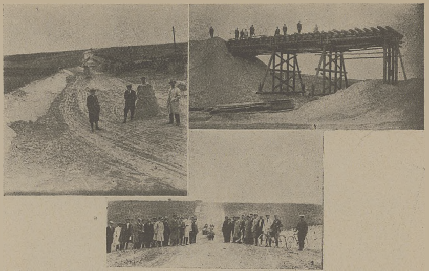
Fragmety z budowy przez Sejmik horochowski drogi bitej, łączącej miasto ze stacją kolejową.
