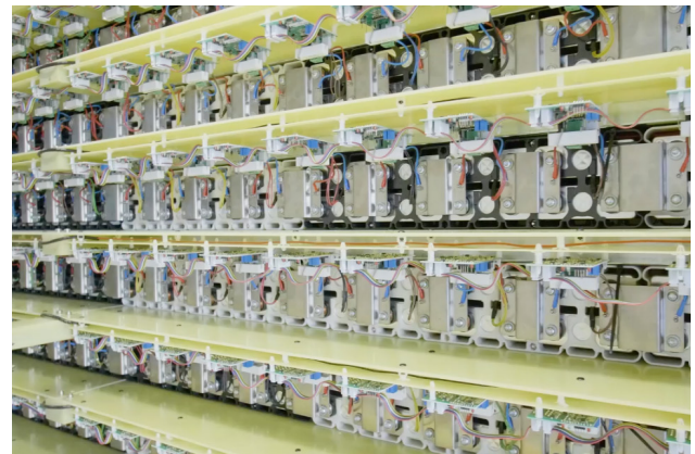
Rys. 2. Baterie litowo-jonowe zamontowane w jednym z kontenerów (źródło: materiały PKP Energetyka S.A.)
