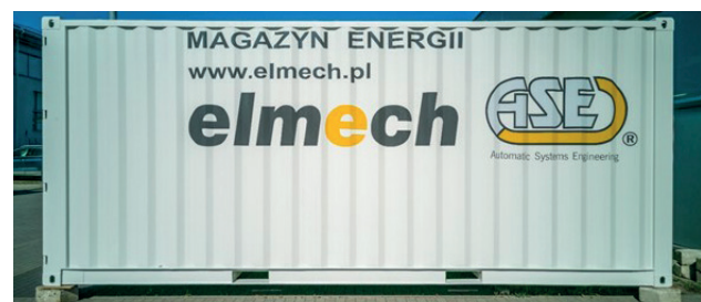
Rys. 1. Magazyn energii Elmech-ASE w zabudowie kontenerowej (źródło: materiały Elmech-ASE Sp. z o.o.)
