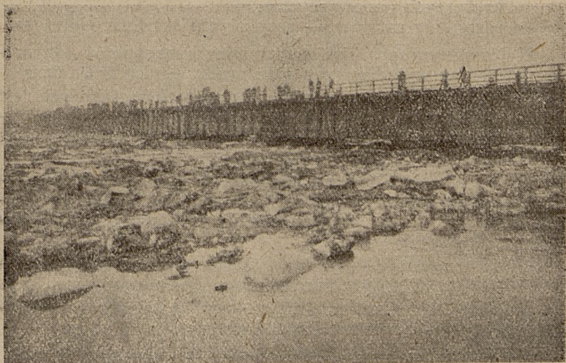
Rys. 2. Spiętrzenie brył lodowych sięgające do spodu konstrukcji nośnej mostu drogowego
