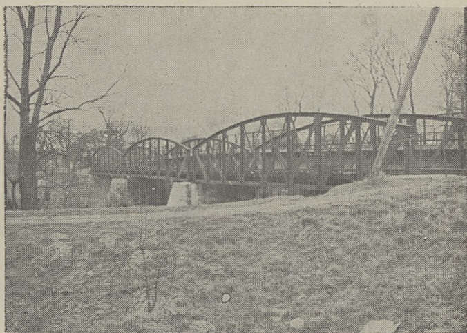
Zdjęcie 8. Obiekt nr 6F — most stalowy kolei wąskotorowej na rzece Libawa w rejonie 0,8 km płn m. Kosowo
