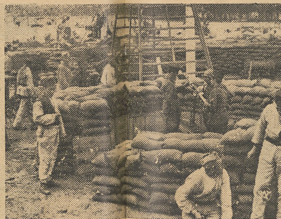
Na wielkim placu przed Pałacem Inwalidów w Paryżu rozpoczęto prace nad przygotowaniem organizowanej Wystawy Obrony Przeciwlotniczej. Na zdjęciu — budowa schronów i okopów, za którymi zostaną ustalone baterie przeciwlotnicze w czasie trwania wystawy.
