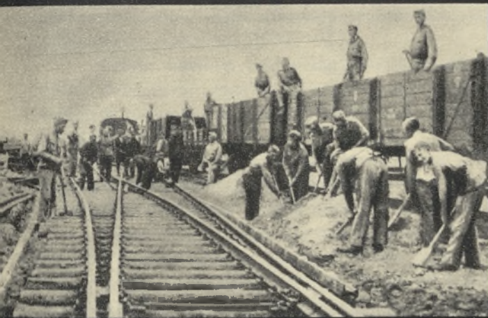
obozu wyszkoleniowego KPW. w Druskiénikach. Prace przy ukladaniu nawierzchni linii kolejowej Porzeccze — Druskiéniki.
