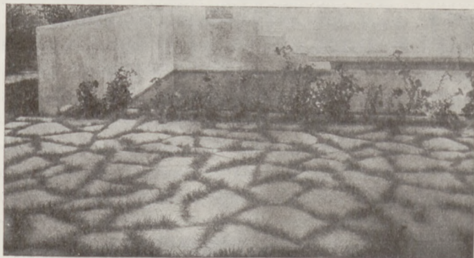
Chodnik betonowy z nieregularnych płyt, w szczelinach którego rośnie trawa
