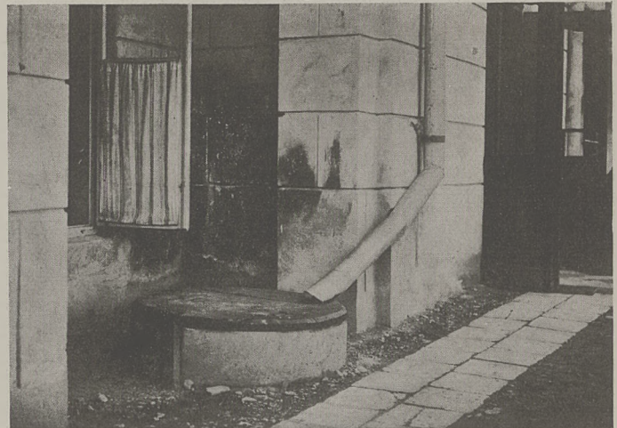
Fot. 1. Zbiornik na wodę, zbudowany nieszczelnie i ze zbyt chudego betonu, zawilgotnił ścianę budynku.
