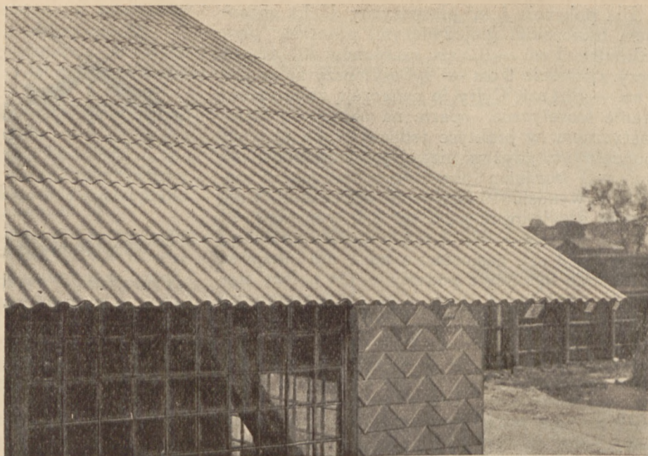
Fig. 5. Dach hali na terenie fabryki pokryty eternitem falistym oraz ściany, wyłożone eternitem.
