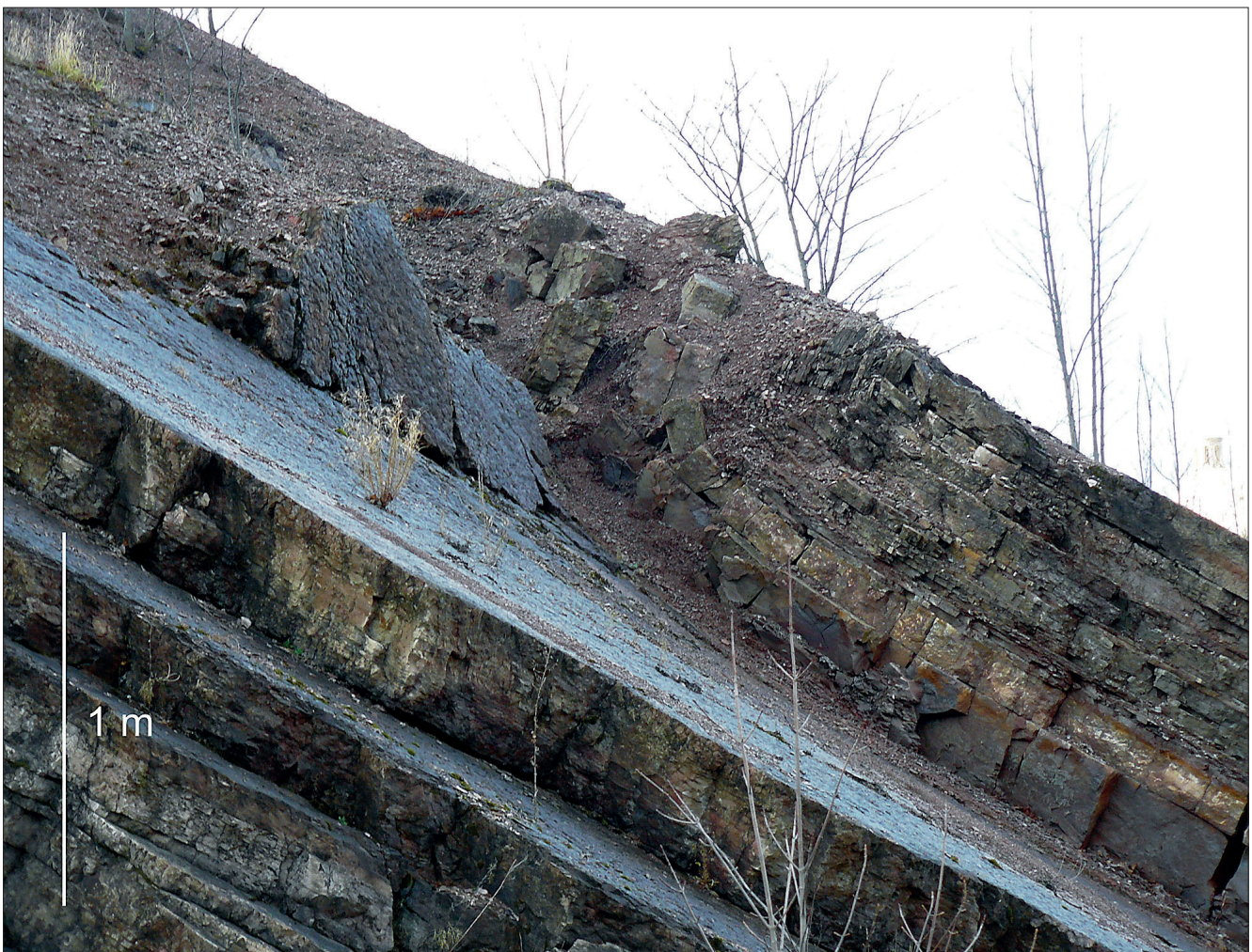
Fig. 13. Haki boczowe z cienkich ławic dolomitów, które zostały pokruszone i odgięte prostopadle względem pierwotnego ułożenia, pod wpływem grawitacyjnego zsuwania nadległych warstw skalnych, podciętych wyrobiskiem (Fig. 1B, pkt 7), fot. Z. Złonkiewicz • Slope hacks of thin dolomite beds that got cracked and bowed vertically by gravitational slide of overlying beds, cut by the quarry mining (Fig. 1B, stop 7), photo Z. Złonkiewicz
