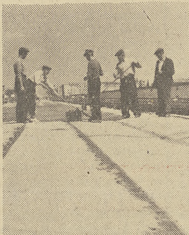
Prace przy moście Śląsko-Dąbrowskim w W-wie dobiegają końca. Obecnie zakłada się izolację pod linie tramwajowe.
