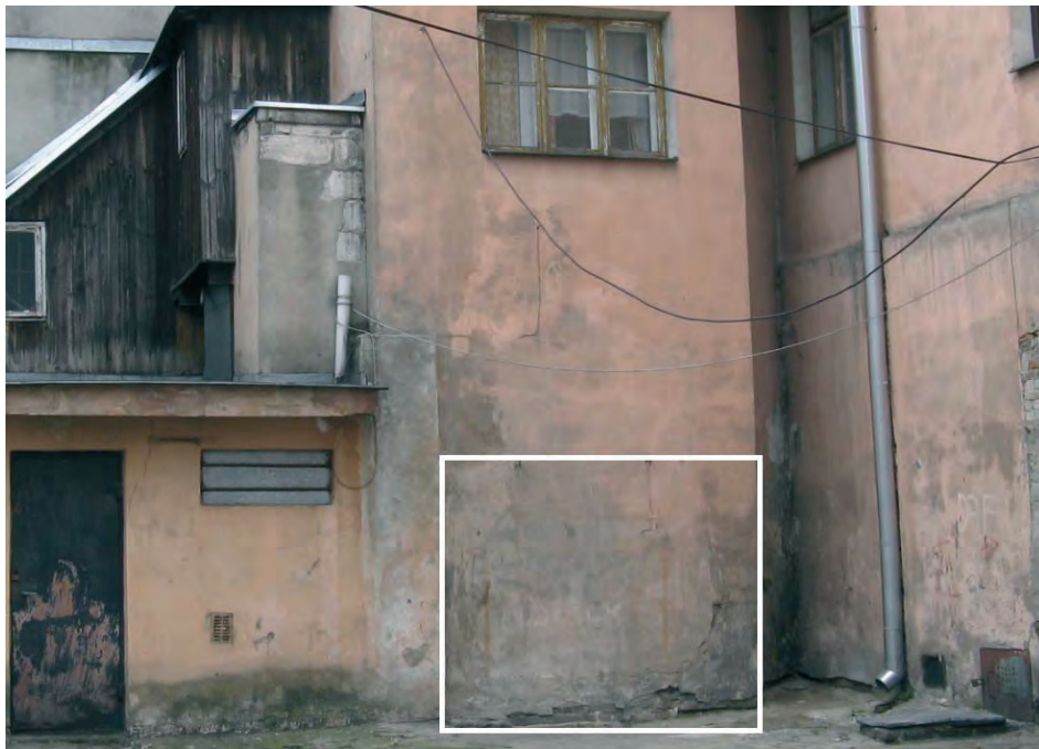
Rys. 4. Powierzchnia zewnętrzna omawianej przegrody (prostokątem oznaczono badany obszar) z wyraźnymi oznakami zniszczenia i korozji biologicznej wywołanymi podciąganiem kapilarnym, (źródło: opracowanie własne).
