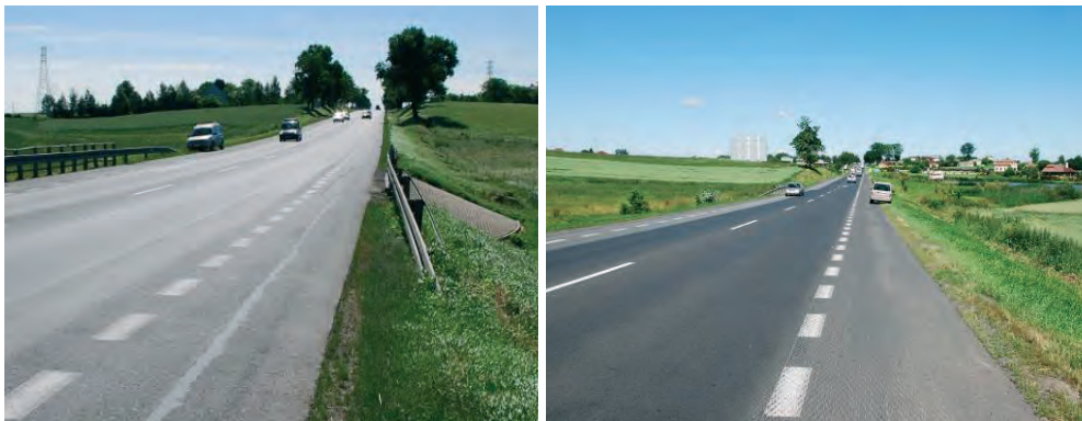
Fot. 1. Widok w ciągu drogi krajowej Nr 12/17 w kierunku m. Lublin oraz w kierunku m. Kurów [10].
