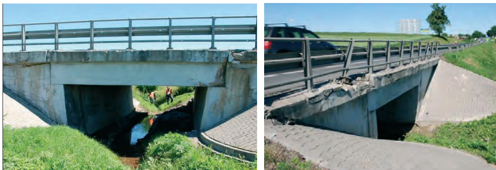
Fot. 3. Widok mostu wraz z uszkodzeniami: od strony napływu i od strony odpływu [10].
