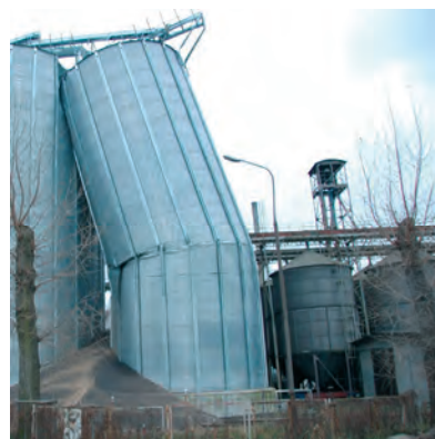
Rys. 2. Awaria stalowego silosu na zboże
