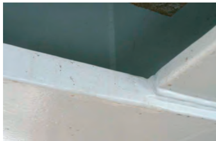
Rys. 5. Wadliwa spoina łącząca pas dolny poprzeczniczy z pasem dolnym dźwigara dla przebadanego mostu B
