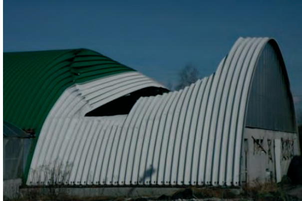
Rys. 3. Awaria przykrycia łukowego z blach cienkościennych systemu ABM 120 [16]
