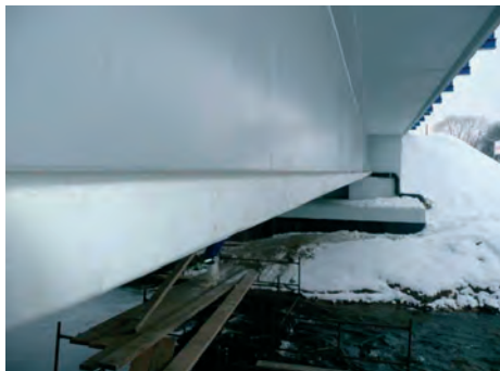
Rys. 2. Widok skrajnego dźwigara głównego mostu B. Widoczne ugięcie pasa dolnego
