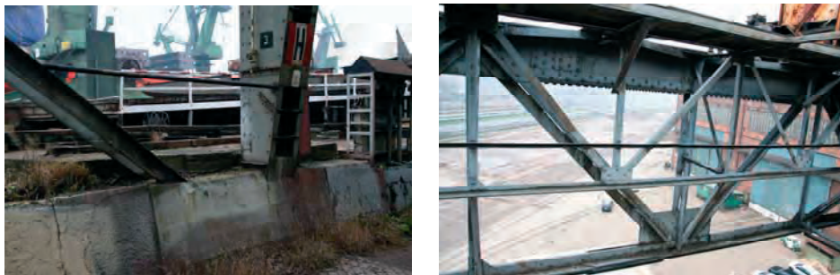
Rys. 3. Typowe stwierdzone uszkodzenia konstrukcji
