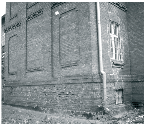
Rys. 2. Widok na S-W część obiektu - ubytki cegieł w ścianie piwnicy spowodowane uszkodzeniami mrozowymi i obecnością soli rozpuszczalnych [6].
