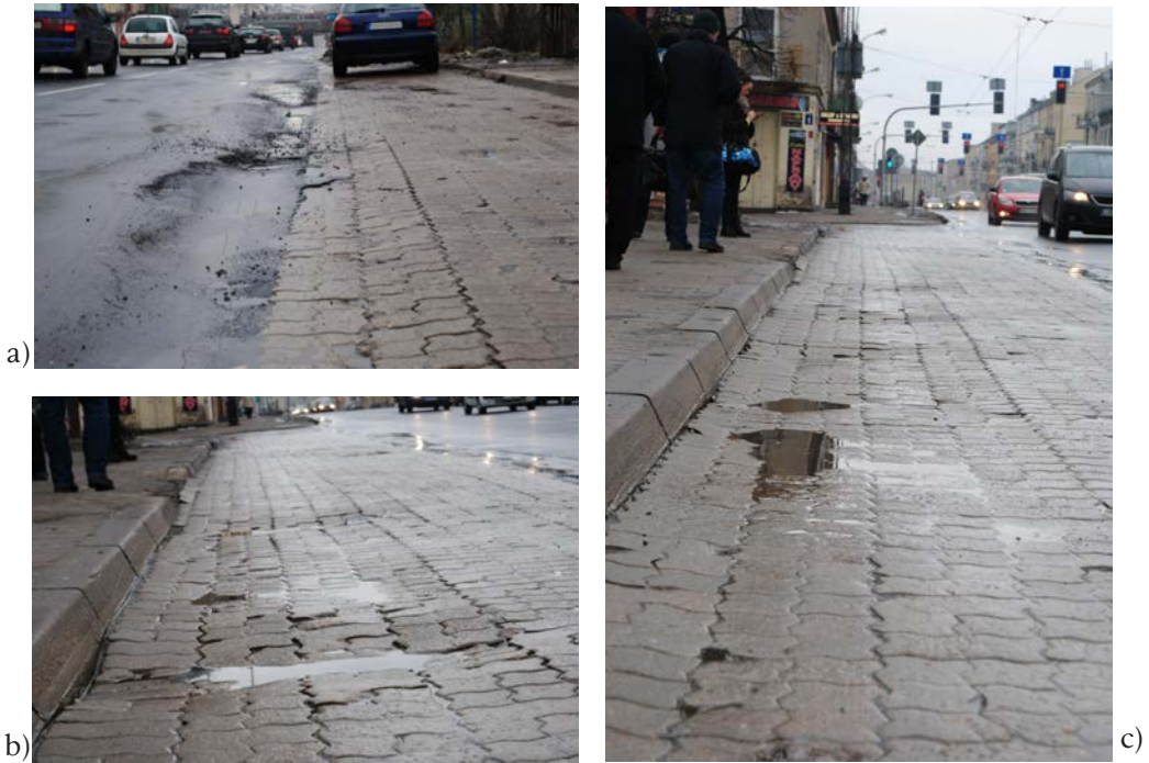
Fot. 3. Uszkodzenia konstrukcji zatoki autobusowej z kostki betonowej a) osiadanie nawierzchni na styku zatoki oraz jezdni b) c) garby poprzeczne przez zatokę [15].
