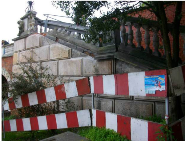
Fot. 14. Widok schodów wraz z uszkodzeniami: braki płyt licowych z kamienia, częściowe zniszczenie i degradacja balustrady [3].
