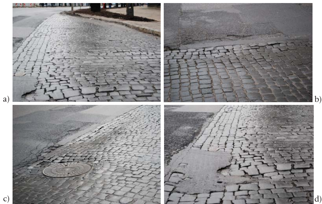
Fot. 2a - d. Uszkodzenia konstrukcji zatoki autobusowej z kostki bazaltowej a) poprzeczne przemieszczenia kostek, b), d) osiadanie nawierzchni na styku zatoki z jezdnią c) osiadanie nawierzchni przy studzience rewizyjnej [15].
