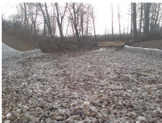
Rys. 2. Ciek pokazany na rys. 1 po wykonaniu zabudowy koryta kruszywem, gabionami i elementami betonowymi (fot. A. Dąbal).
