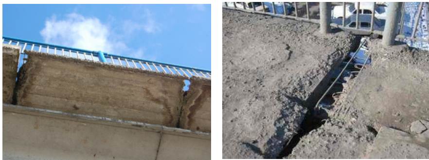
Rys. 22-23. Korozja żelbetowych płyt chodnikowych mostu na ulicy Roweńskiej.
