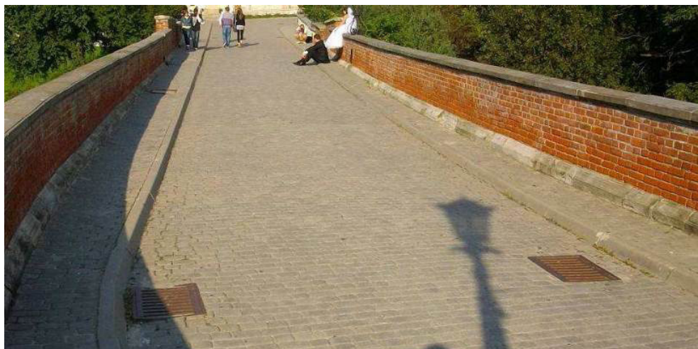
Fot. 8. Nieprawidłowe odległości między wpustami, niezgodne z wymaganiami spadki nawierzchni, deformacje nawierzchni oraz obniżenie nawierzchni względem wpustów [4].
