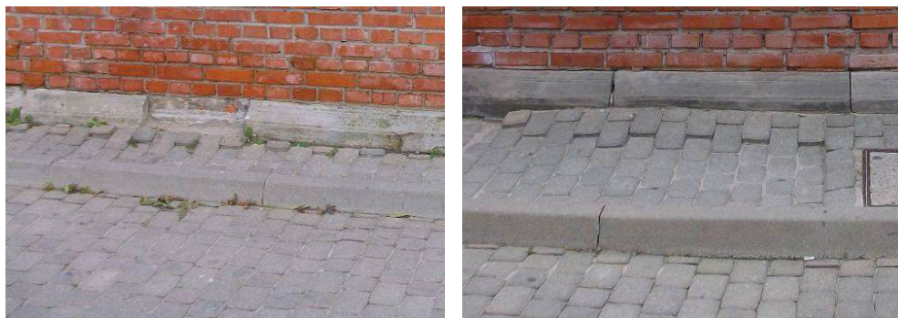
Fot. 9. Zapadnięcie części elementów nawierzchni [4].
