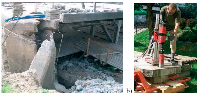
Rys. 3. Obraz częściowej rozbiórki z fragmentami betonu pobranego do badań laboratoryjnych, a) przyczółek od południa, b) pobieranie próbek
