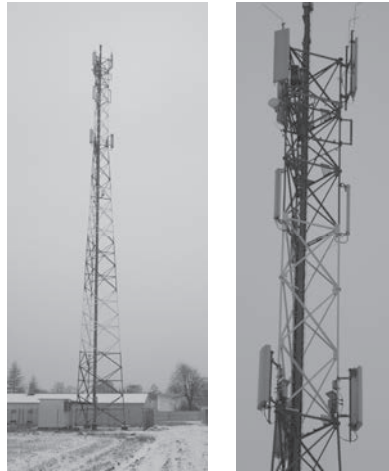
Rys. 2. Przykładowy widok górnej części wieży telekomunikacyjnej i nierównomiernego rozłożenia powierzchni nawietrznych
