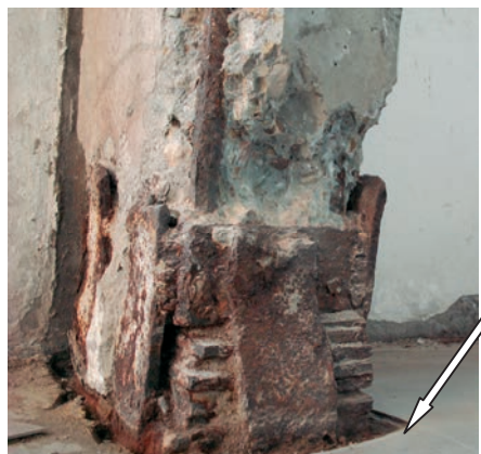
Rys. 7. Uszkodzenia jak obok. Wypełnienie przestrzeni pomiędzy płytą balkonu i podstawą słupa podkładkami stalowymi
