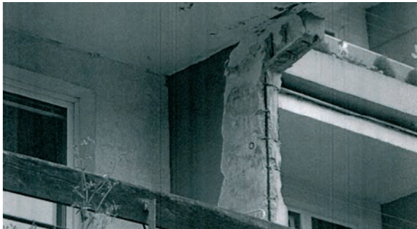
Rys. 4. Korozja ściany pionowej – filaru loggii
