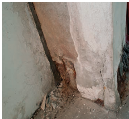
Rys. 6. Uszkodzenia korozyjne podstawy słupa
