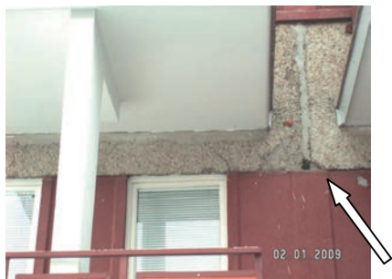
Rys. 15. Uszkodzenia płyt elewacyjnych
