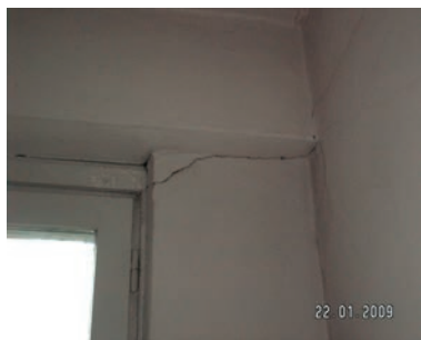
Rys. 13. Przykładowe pęknięcia na połączeniach obudowy i ścian poprzecznych wewnętrznych - klatka schodowa II
