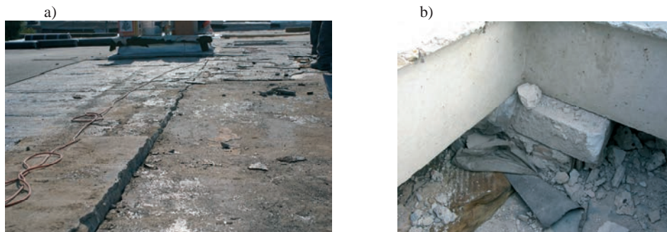
Rys. 5. Uszkodzenie konstrukcji dachu: a) widok zapadniętej płyty dachowej; b) zmiądzzona ścianka wsporcza pod płytą dachową
