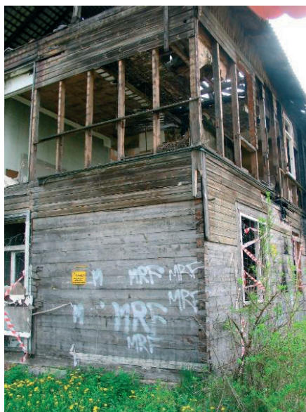
Fot. 2. Konstrukcja ściany jednopiętrowego budynku w tzw. stylu nadświdrzańskim w Radości – na parterze sumikowo-łatkowa kombinowana ze zrębem w węgle, na piętrze szkieletowa (budynek w trakcie rozbierania) – fot. A. Krajewski
