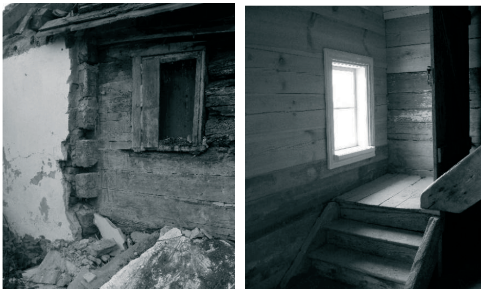
Rys. 16. Zagroda z Kaniczek, strona lewa – stan w trakcie rozbiórki, okno doświetlające schody na poddasze, prawa strona stan po odbudowie na terenie Olęderskiego Parku Etnograficznego w Wielkiej Nieszawce, fot. A. Maślak
