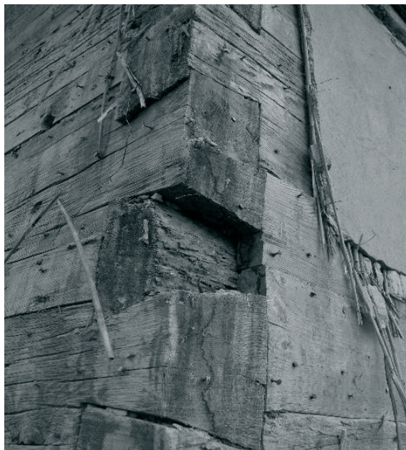
Rys. 13. Zagroda z Kaniczek, stan przed rozbiórką, narożnik części mieszkalne z obciążenymi resztkami i nabitymi deskami, fot. A. Maślak
