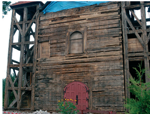
Fot. 13. Stan zachowania ściany w Wylatowie.
