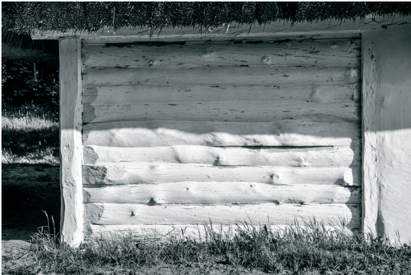
Ryc. 9. Przykładowa ściana zewnętrzna budynku drewnianego, z zachowaną plastyką belek oraz śladami obróbki. Muzeum Wsi Kieleckiej. [Fot. r. Zapłata]
