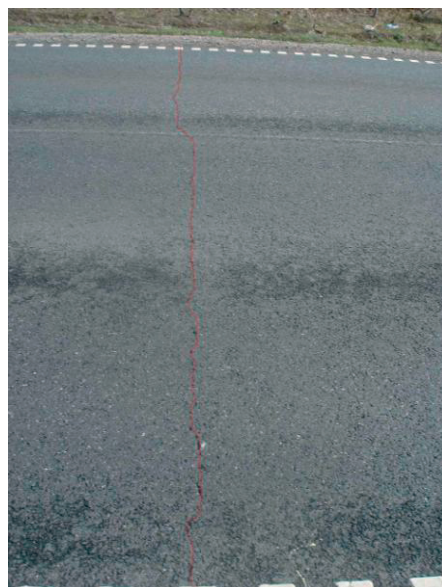
Fot. 2. Spękanie poprzeczne wywołane podbudową z mieszanki MCE
