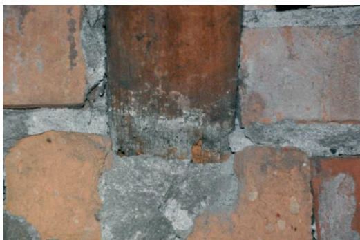
Fot. 10. Żerowisko krokwiowca piłkorożnego w zagrzybionym miejscu styku krokwi z murem. Pozostała większość krokwi bez objawów biokorozji
