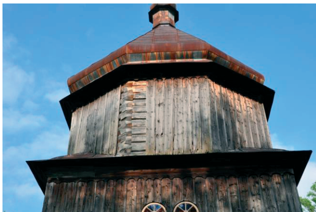
Fot. 5. Szalunek z desek jako forma ochrony zrębu budowli, a szczególnie połączeń ciesielskich. Kilkostopniowe okapy odprowadzające wody opadowe od elewacji zastępujące rolę rur spustowych
