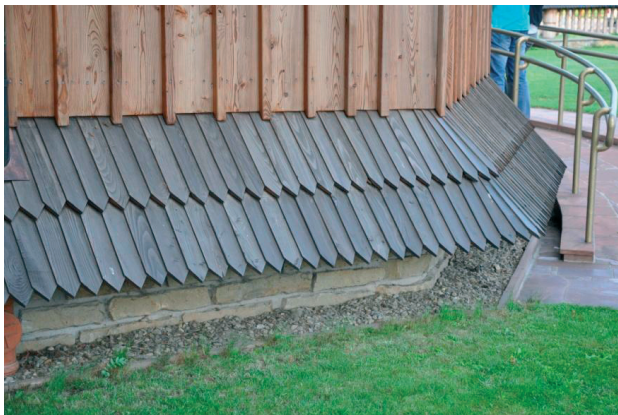
Fot. 4. Osłonięcie podwaliny przed wodami opadowymi przy jednoczesnym swobodnym przepływie powietrza wokół podwaliny.
