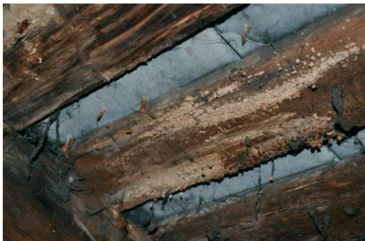
Fot. 8. Szczelne poszycie dachu blachą prowadzące do kondensacji pary i rozwoju zagrzybienia
