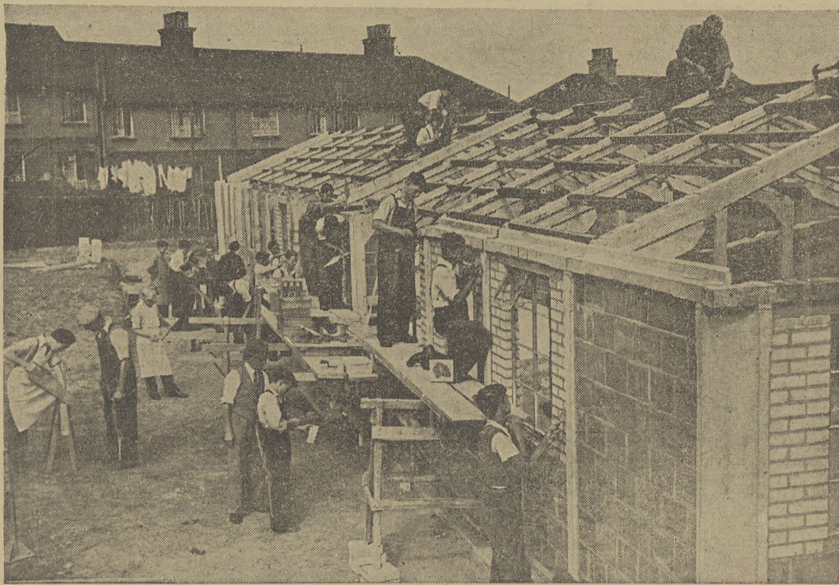
Brytyjskie przedszkolenie budownicze. Czeladnicy budowlani pracują pod dozorem majstrów nad budową przedszkola w Chalcham na zamówienie władz szkolnych Hrabstwa Kent.
