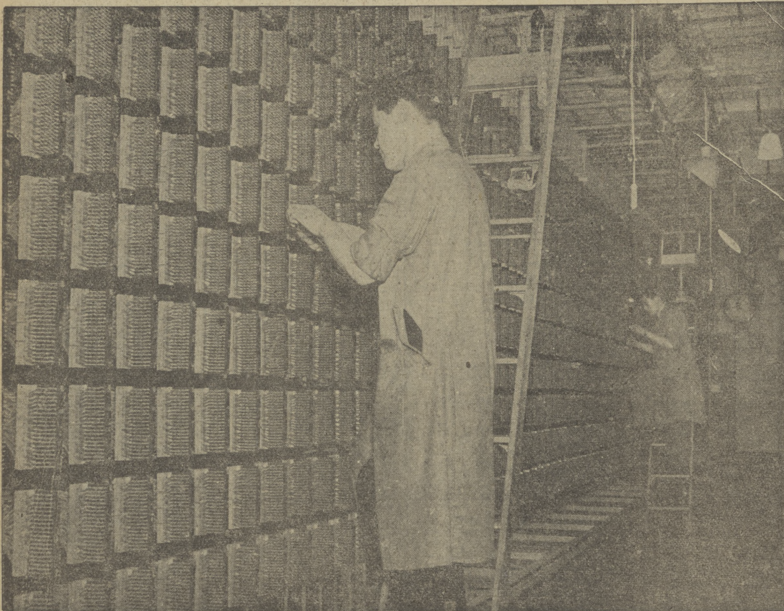
Automatyczna centrala telefoniczna. Rozdzielnia pośrednia. Kable doprowadzone są tutaj z głównej rozdzielni (gdzie uszeregowano są według numerów) i połączone z łącznicą. Dzięki temu ułatwiony jest podział obciążenia na grupy aparatów oraz umiejscowienie uszkodzeń. Sygnał „numer zajęty” połączony jest z numerami zapasowymi.
