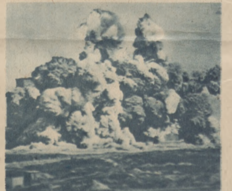
Berliński bunkler niemieckiej artylerii przeciwlotniczej wylataje w powietrze. Do wyładzenia użyto 50 ton dynamitu.
